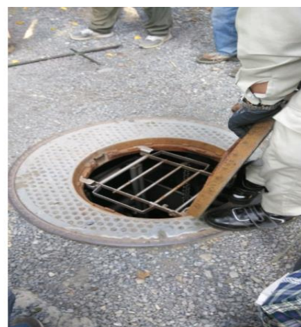
マンホールポンプ設置人孔(腐食が進行)
