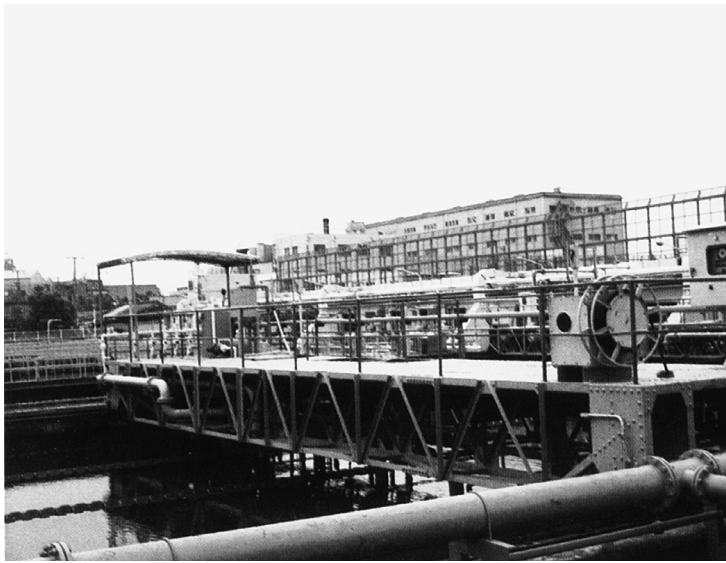
最終沈殿池1号池採泥機(走行サイホン式)
