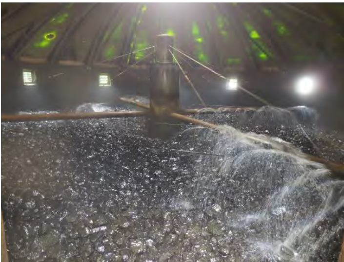
写真-5 散水ろ床の処理状況
