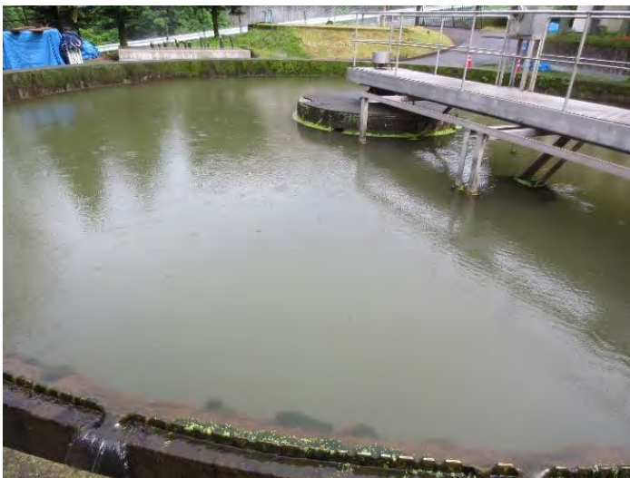
写真-6 最終沈殿池
