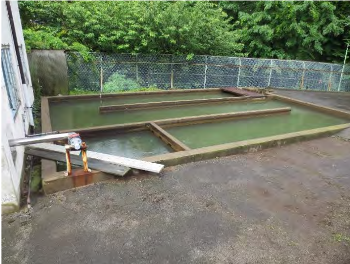
写真-7 塩素混和池
