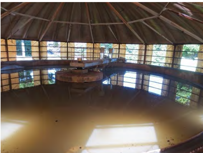
写真-3 最初沈殿池
