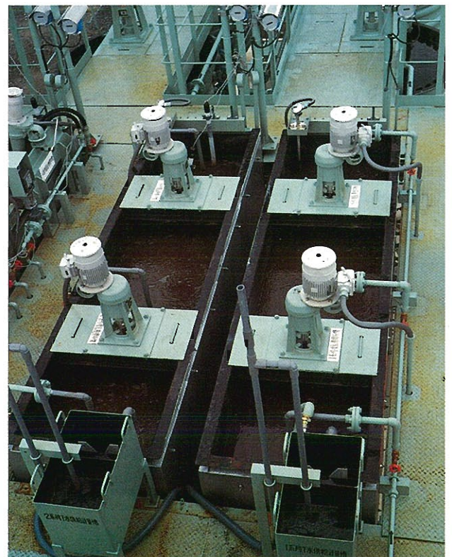
写真1 パイロットプラントのリアクター (I系とII系)
