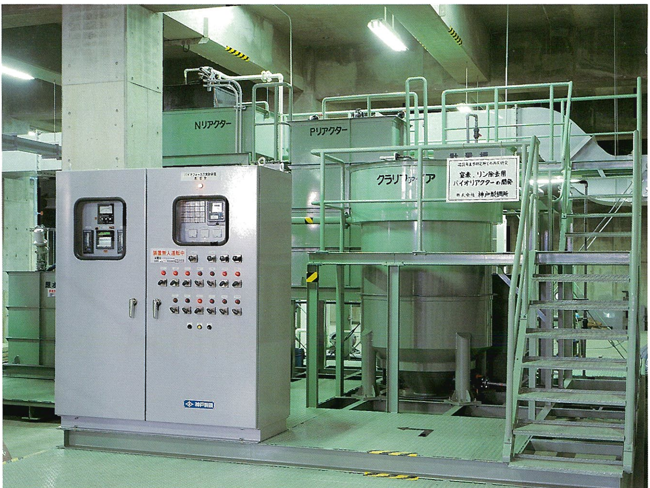
▲パイロットプラント (神戸市垂水処理場内)
