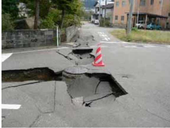
写真 - 1 管路埋設路線上の地盤沈下（小千谷市）
