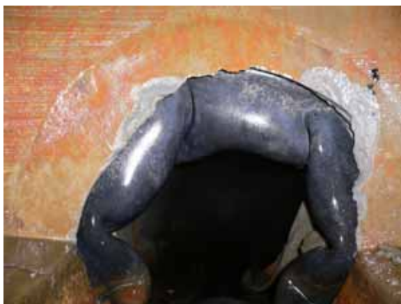
写真 - 5 マンホールと管きよの接合部のズレ（長岡市）
