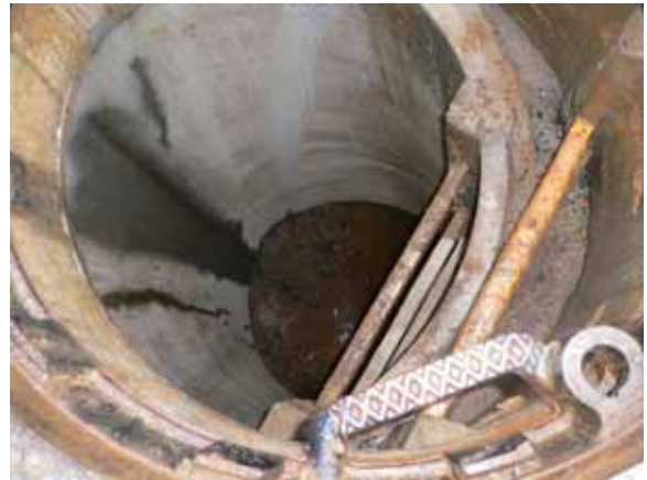
写真 - 4 マンホール躯体のズレ（堀之内町）
