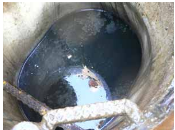
写真 - 6 マンホール内の滞水状況（堀之内町）
