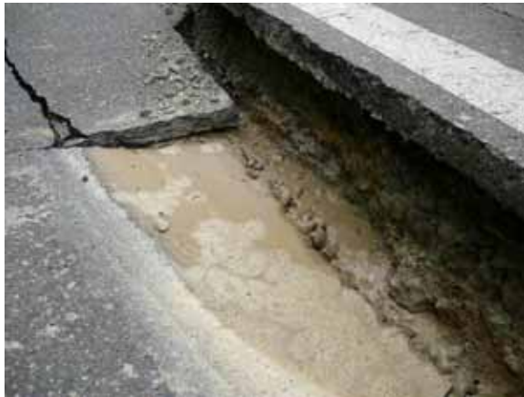
写真 - 3 道路沈下割れ目からの噴砂（小千谷市）
