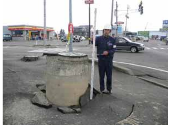
写真 - 2 マンホールの浮上がり（小千谷市）
