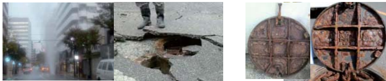
内圧による蓋の浮上飛散 ⇒ 事故 腐食 ⇒ 蓋の強度低下・開閉不能 錠・蝶番欠落
