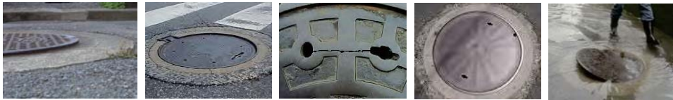
段差 ⇒ つまづき・転倒 がたつき ⇒ がたつき音 蓋外れ 破損 ⇒ 事故 表面摩耗 ⇒ スリップ事故 転倒 冠水時の蓋外れ ⇒ 転落事故
