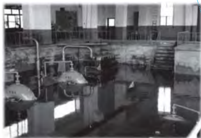
水没したポンプ所内
