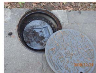
点検孔 2重蓋 滑り止め塗装
