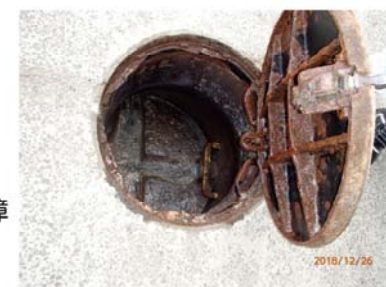
高尾山駅上流の蓋の腐食
