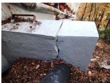
コンクリート基礎のずれ
