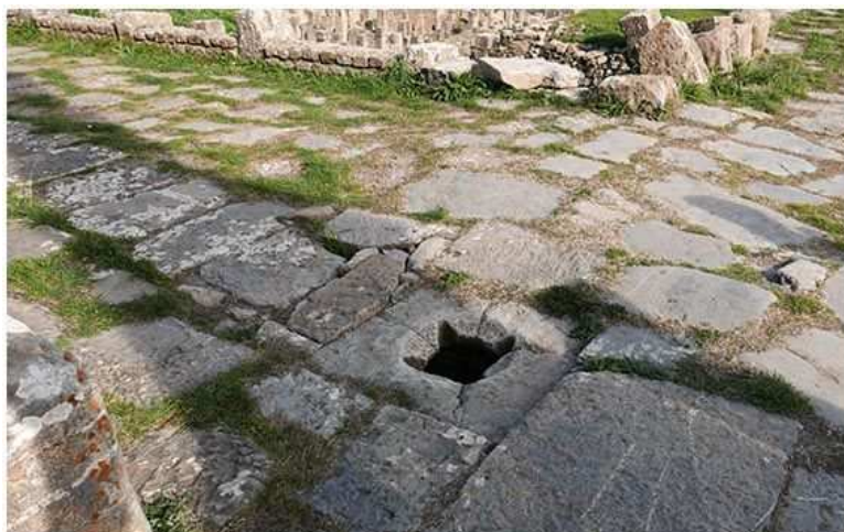
↑上写真。ジェミラ遺跡 下水道と人孔 中央部のスリットが欠けて大きな穴に
