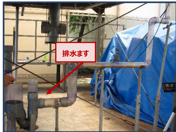
写真 戸建住宅排水実験装置
